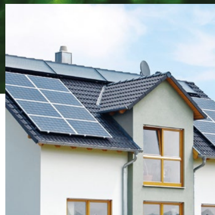
MODUŁY I INWERTERY FOTOWOLTAICZNE
